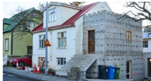
En er verið að byggja hús í kastalastíl í Reykjavík, hér nýbygging við Laufásveg
